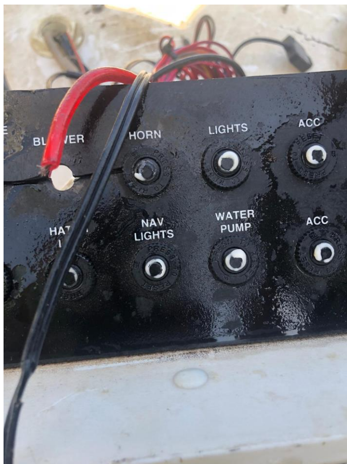
Figura 21. Estado en el que fue hallado el panel de accionamiento de varios servicios de la E/R INDIA, entre ellos, las luces de navegación.
