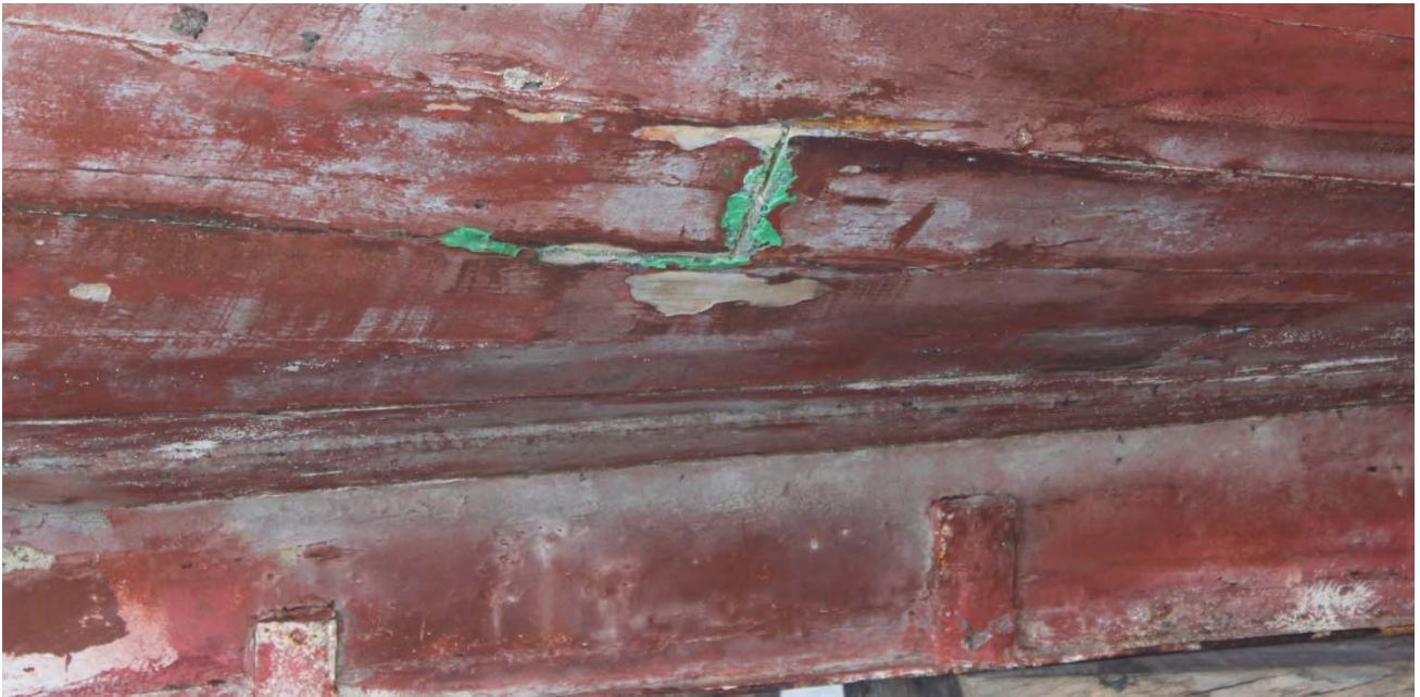
Figura 8. Restos de la reparación temporal de una pequeña vía de agua en el costado de babor de la obra viva
