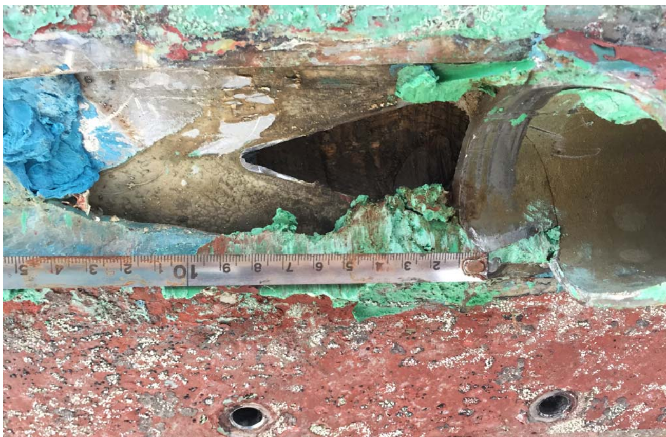
Figura 15. Detalle de la rotura de la chapa de fijación del pasacasco al casco de la embarcación
