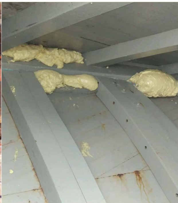
Figura 21. Reparaciones efectuadas en el interior del casco de la embarcación S'ESTURION después del accidente del 19 de agosto de 2018
