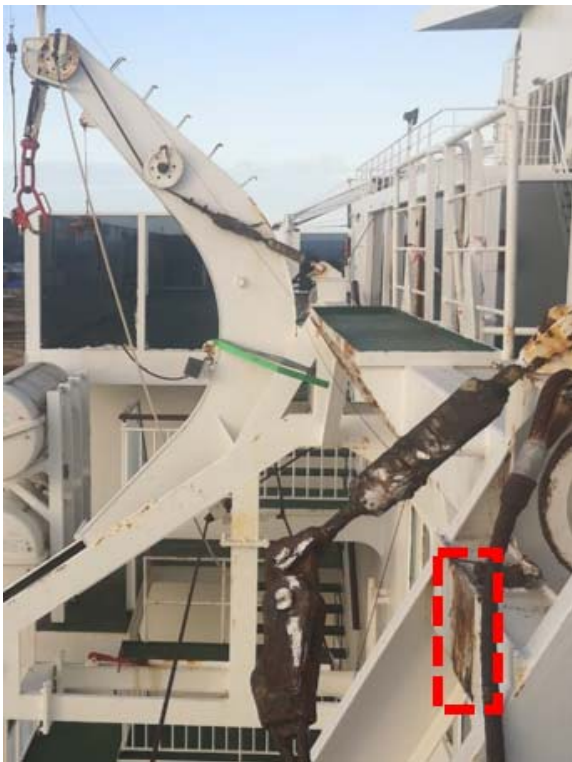
Figura 15. Marca de contacto del brazo del pescante con el marco fijo. En la imagen también se pueden apreciar los tensores de ambos cables
