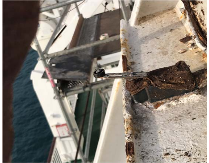
Figura 17. Posición del interruptor fin de carrera instalado en el marco fijo del pescante, a proa.
