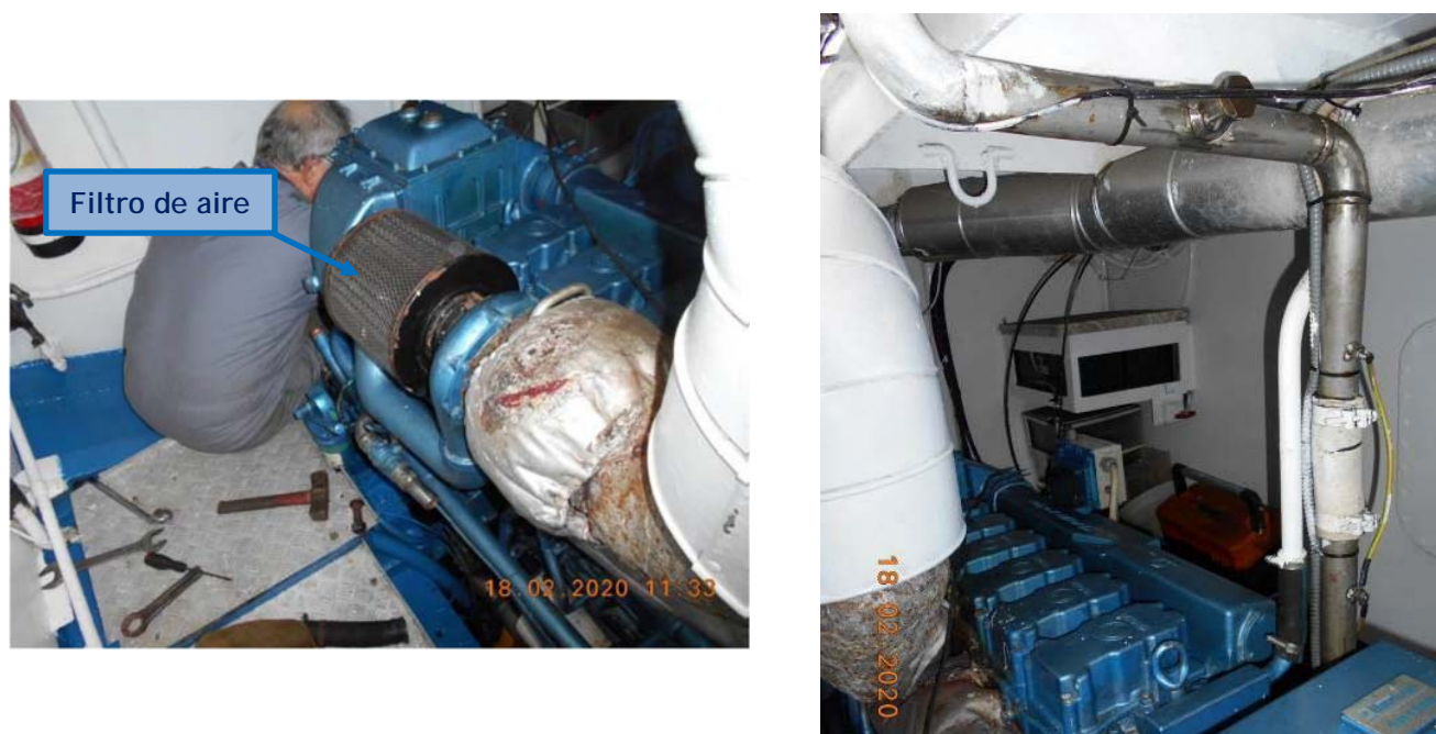
Figura 8. Interior de la cámara de máquinas (fuente: compañía aseguradora)
