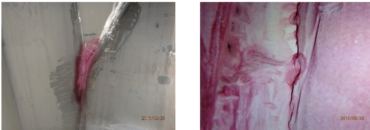
Figura 8. Grieta actual (vista desde COT#12P) y detalle de la misma.
