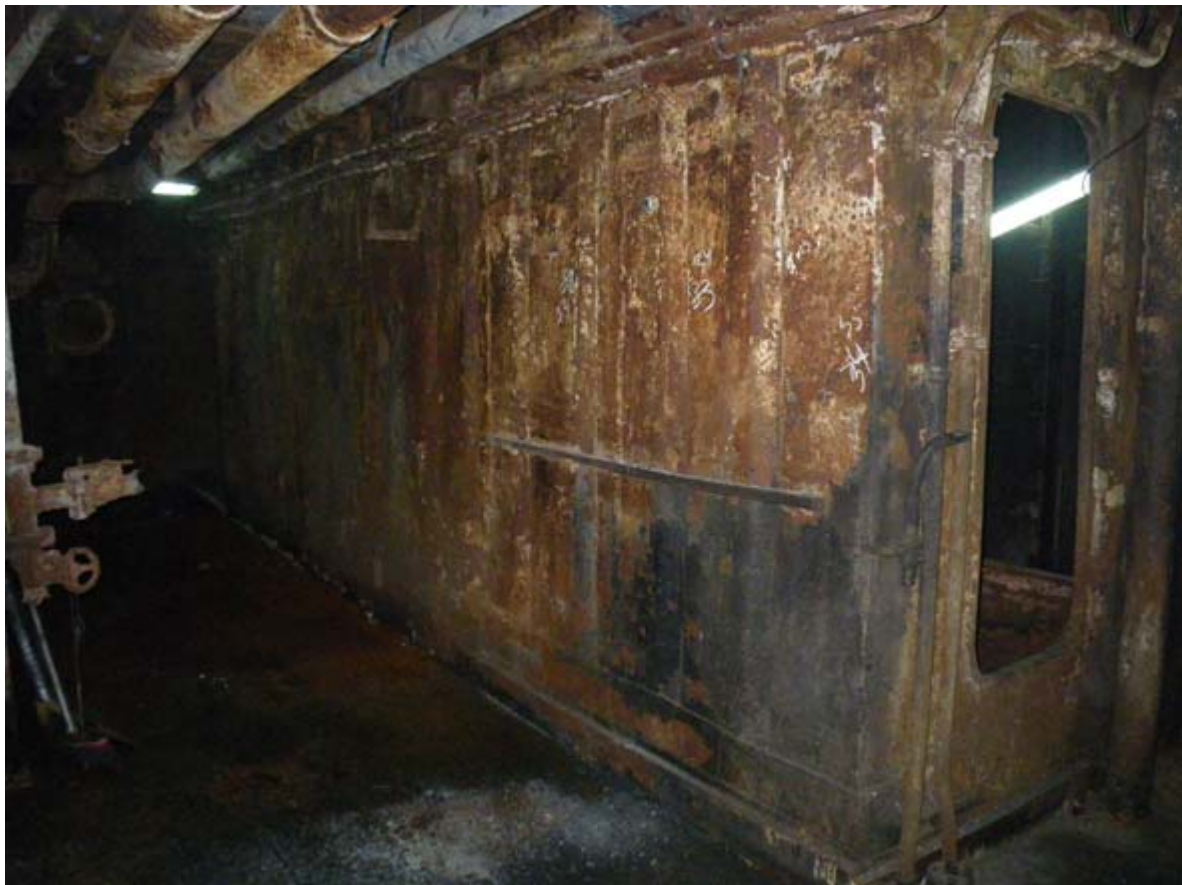
Figura 8. Estado del mamparo de la sala de control de la factoría una vez finalizadas las operaciones de limpieza previas a su reparación eventual.
