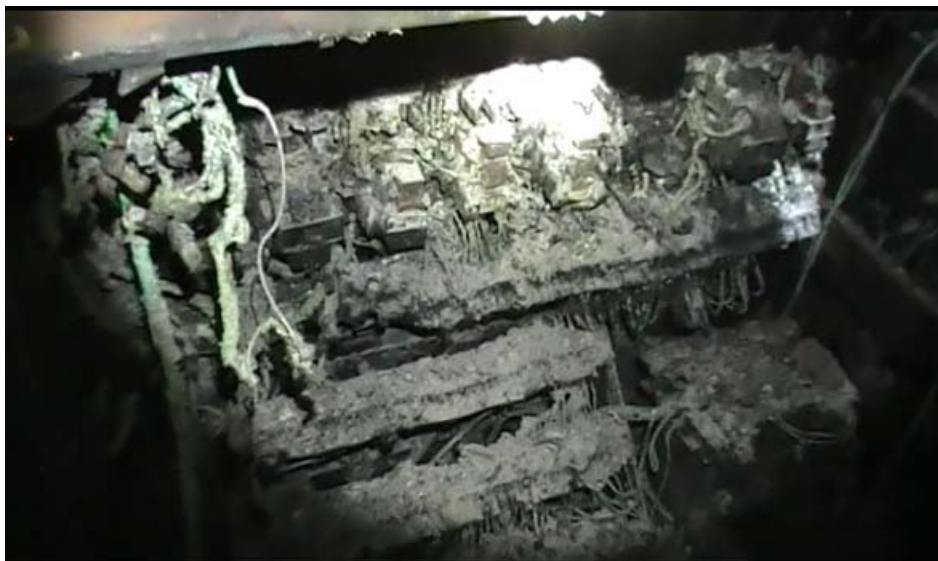
Figura 10. Estado del interior de uno de los cuadros eléctricos de la cámara de control de la factoría
