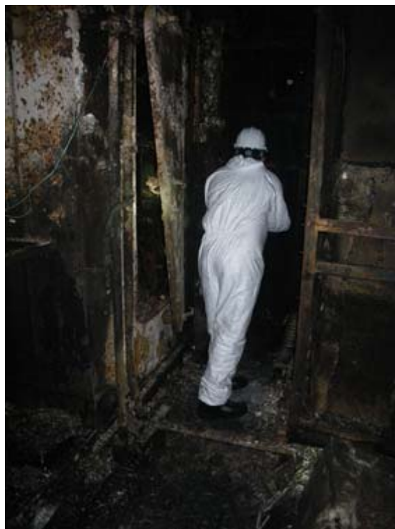
Figura 11. Puerta deformada de acceso al cuarto de control desde la factoría
