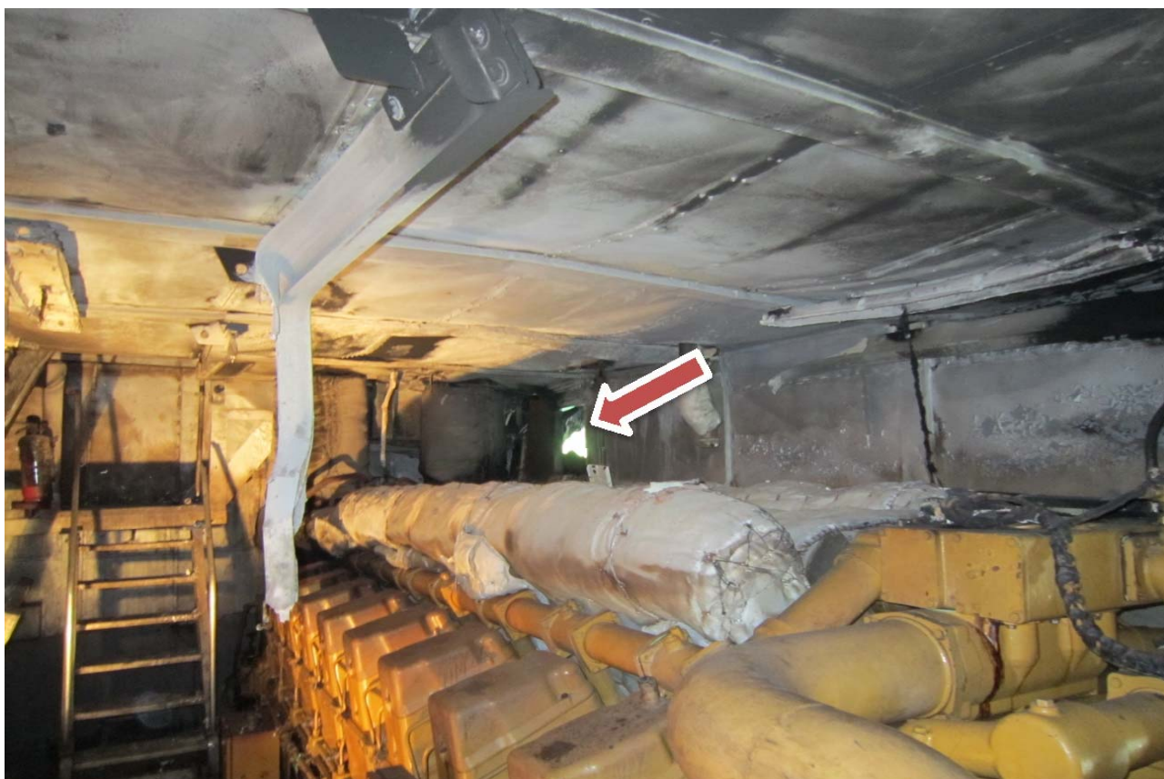
Figura 7. Vista general de la sala de máquinas de estribor; vista hacia popa con el SIME en primer plano
