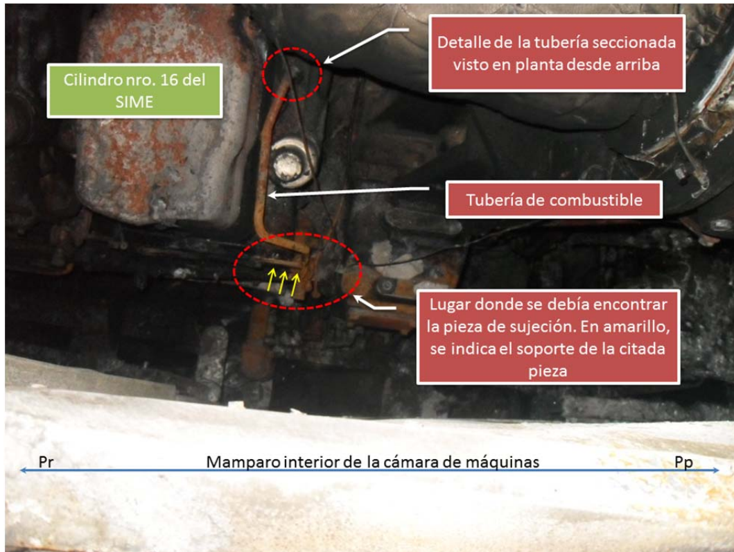
Figura 8. Estado de la tubería de combustible del inyector del cilindro nro. 16 del SIME.
