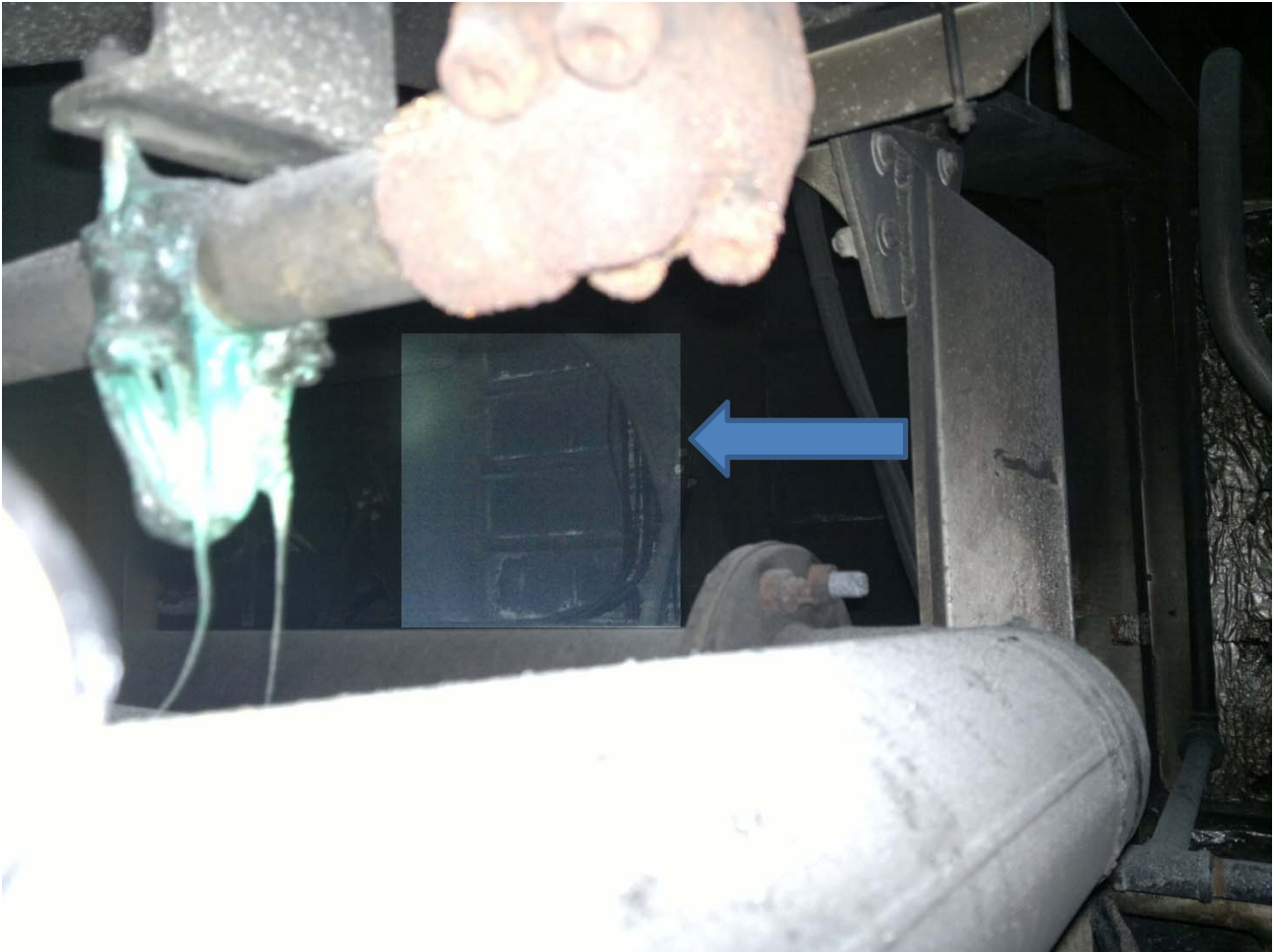
Figura 16. Detalle resaltado y clareado del mazo de cables portante de la señal de disparo remoto de CO 2 . Nótese el detalle de la abrazadera de plástico derretida en primer plano, consecuencia de las temperaturas alcanzadas en el recinto.
