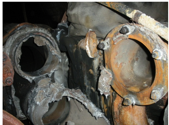
Figura 12. Detalle del estado en que quedó el codo de aluminio del colector de aire
