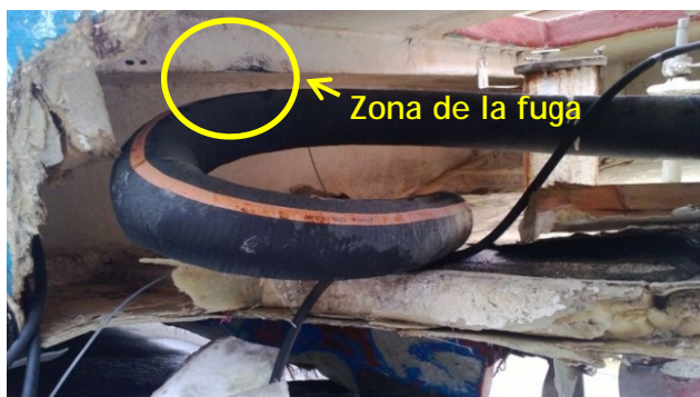
Figura 6. Tubería del escape húmedo
