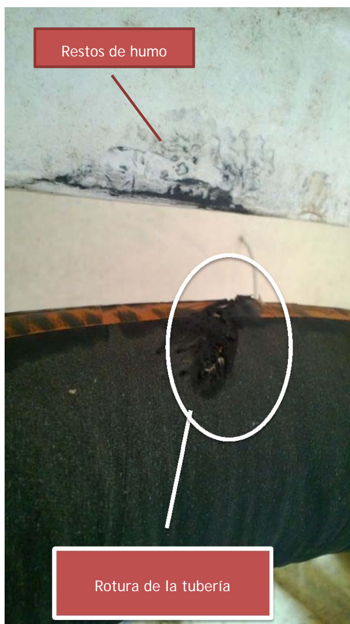
Figura 9. Detalle de la zona de la rotura
