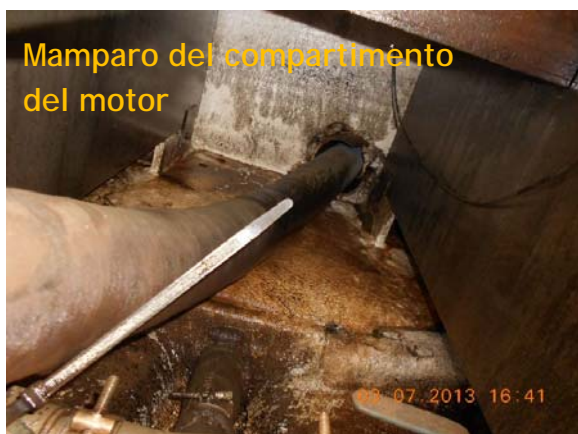
Figura 8. Manguera flexible en el compartimento del motor
