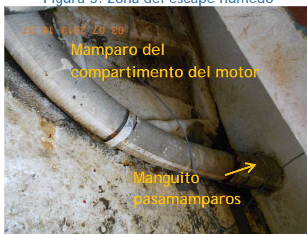
Figura 7. Tubería del escape en el compartimento del servotimón
