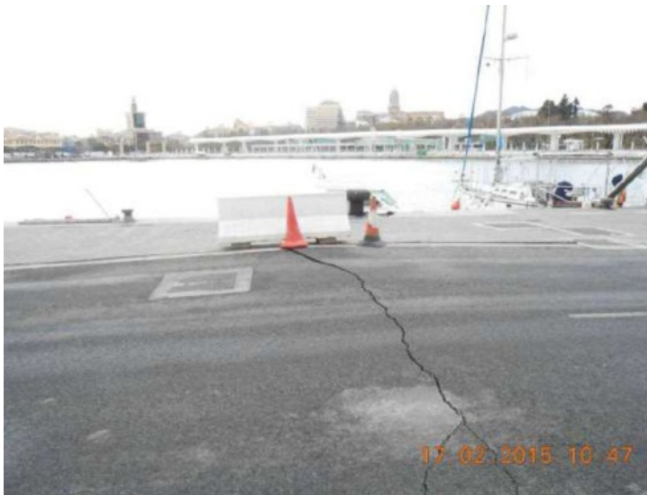
Figura 5. Daños en muelle
