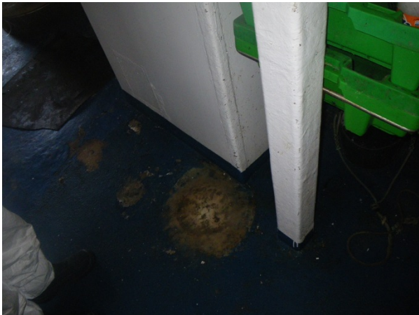
Figura 11. Marca dejada por la ventilación
