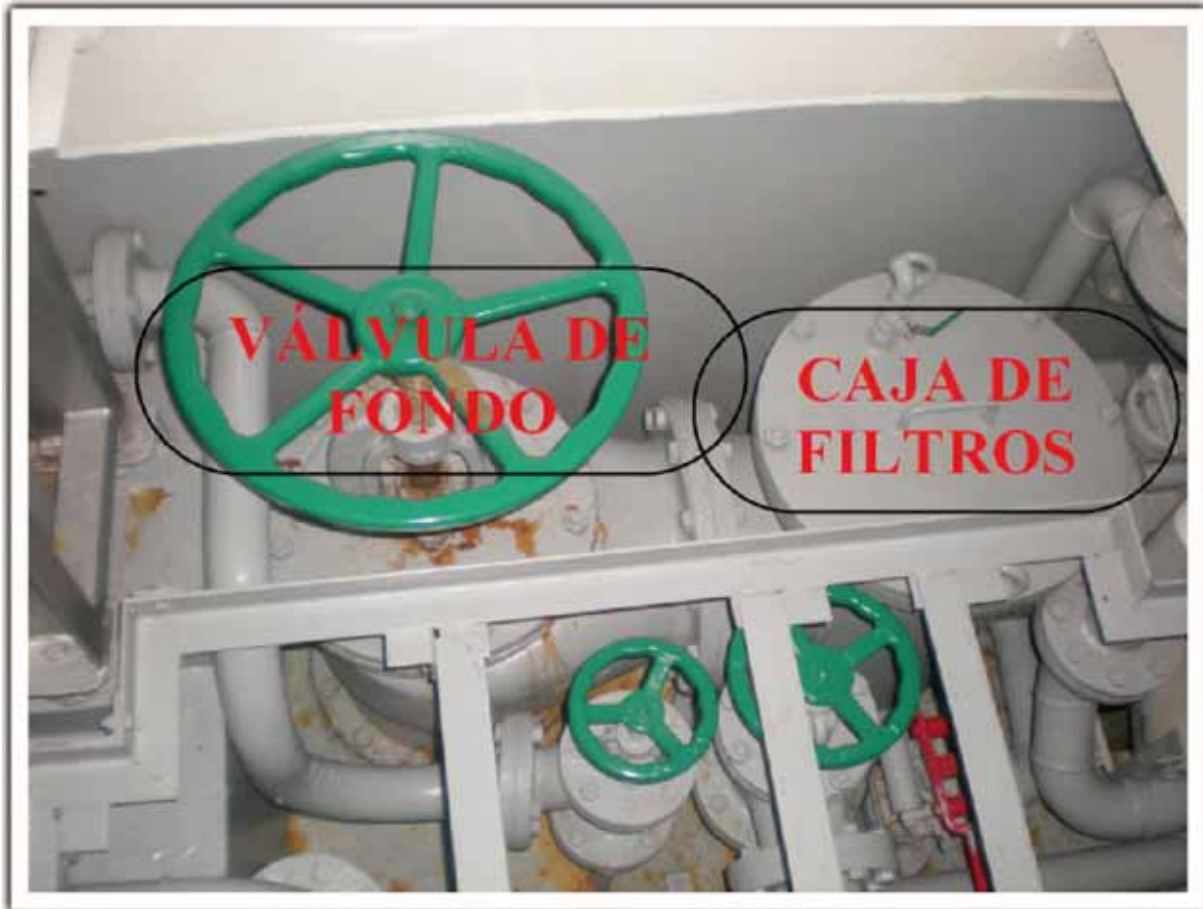
Figura 16. Caja de filtros de la línea principal de agua salada del B/P MONTE MEIXOEIRO
