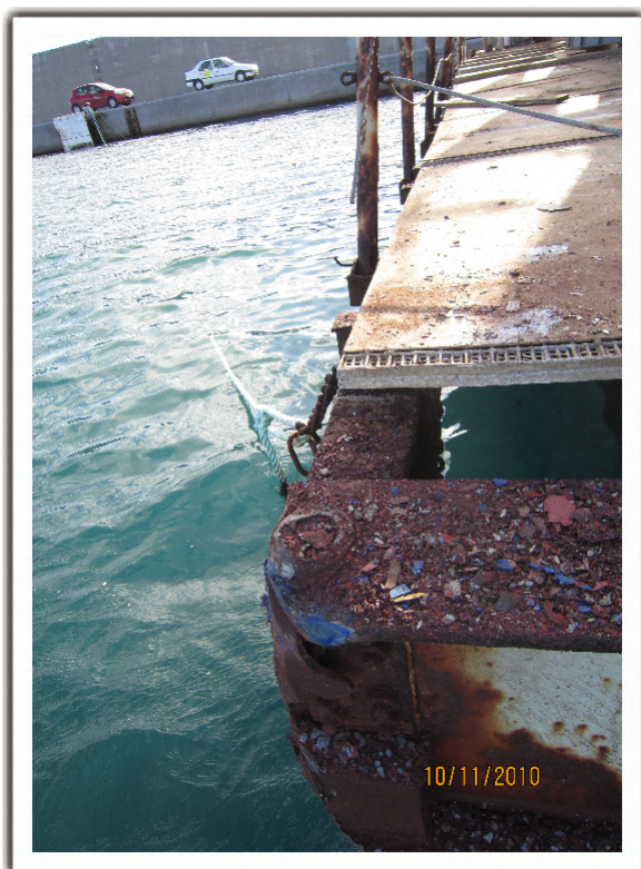
Figura 3. Detalle de la zona de la plataforma con la que colisionó el buque ACE II en el Muelle Dique
