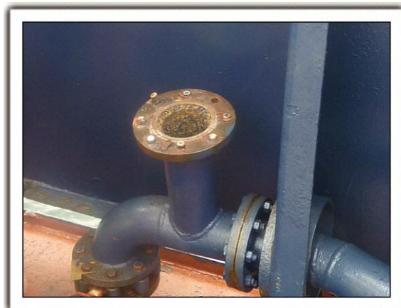
Figura 8. Detalle de la brida con los tornillos rotos
