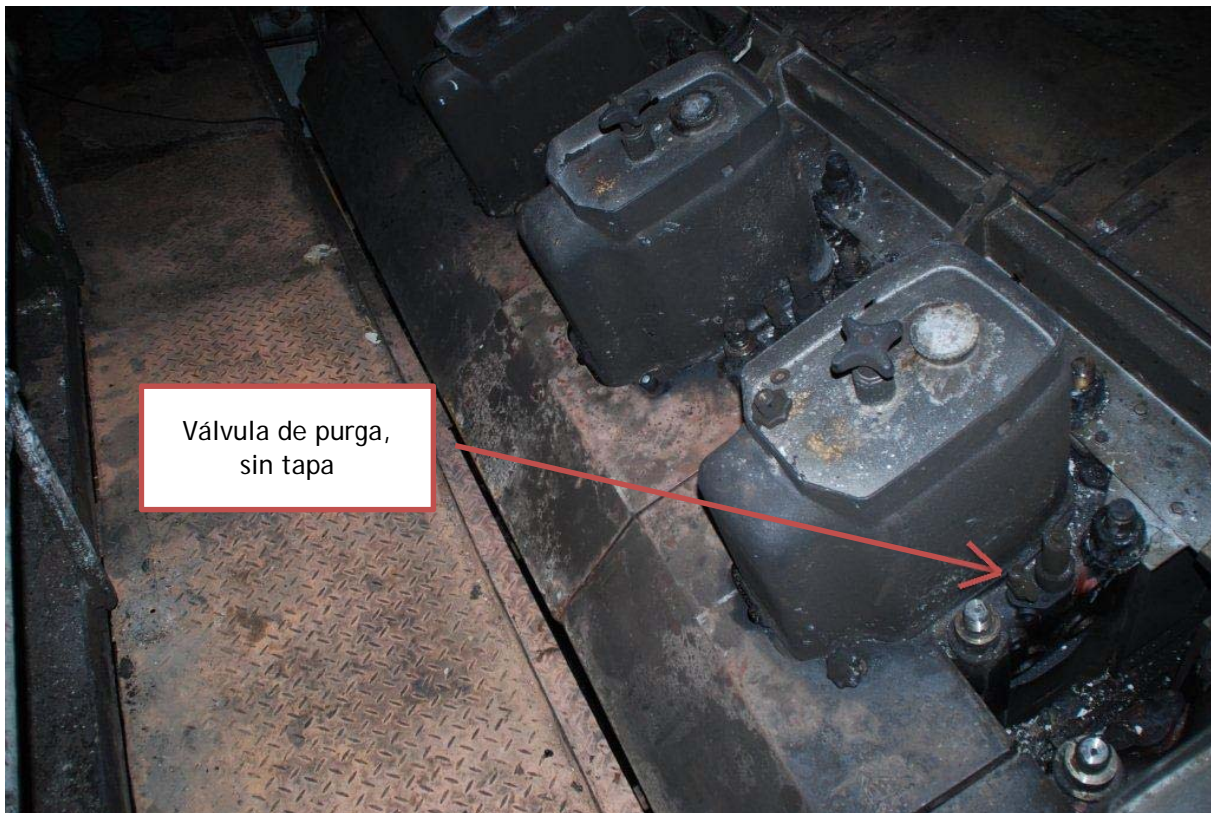
Figura 5. Fotografía del motor, tras el incendio, donde se aprecia la falta de las tapas de protección de las válvulas de purga en varios cilindros
