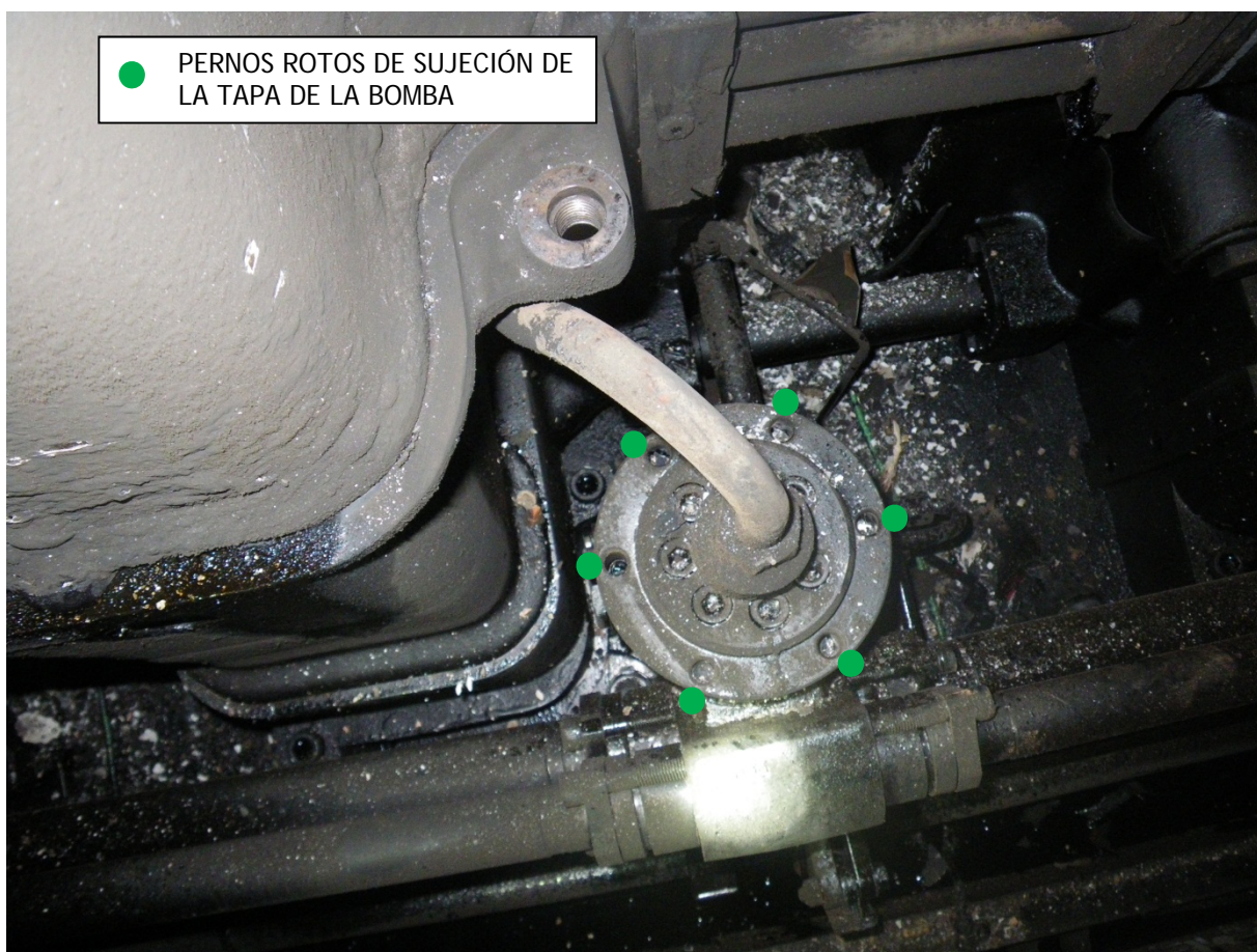
Figura 3. Aspecto de la bomba de inyección de combustible del cilindro A-4 tras el incendio
