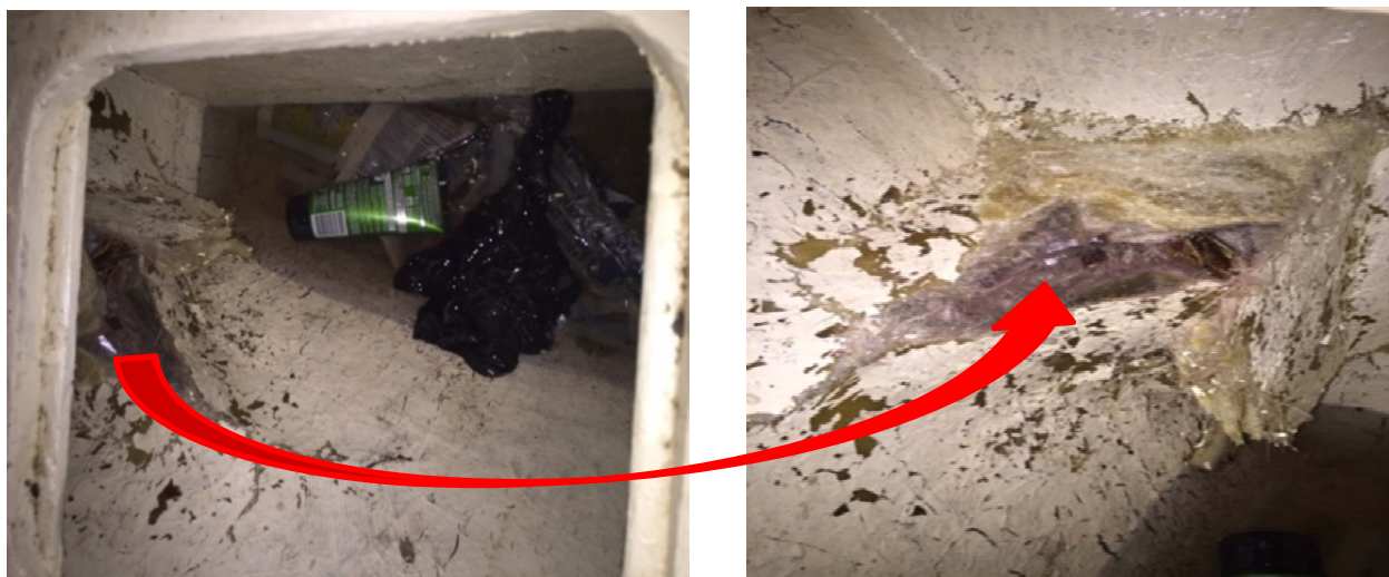
Figura 5. Daños en el interior. Detalle.
