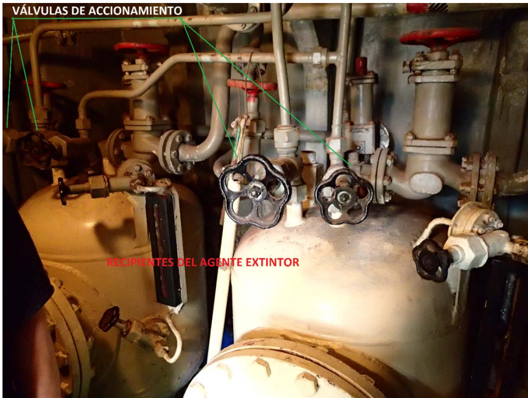
Figura 27. Instalación de Halón para extinción en Sala de Máquinas
