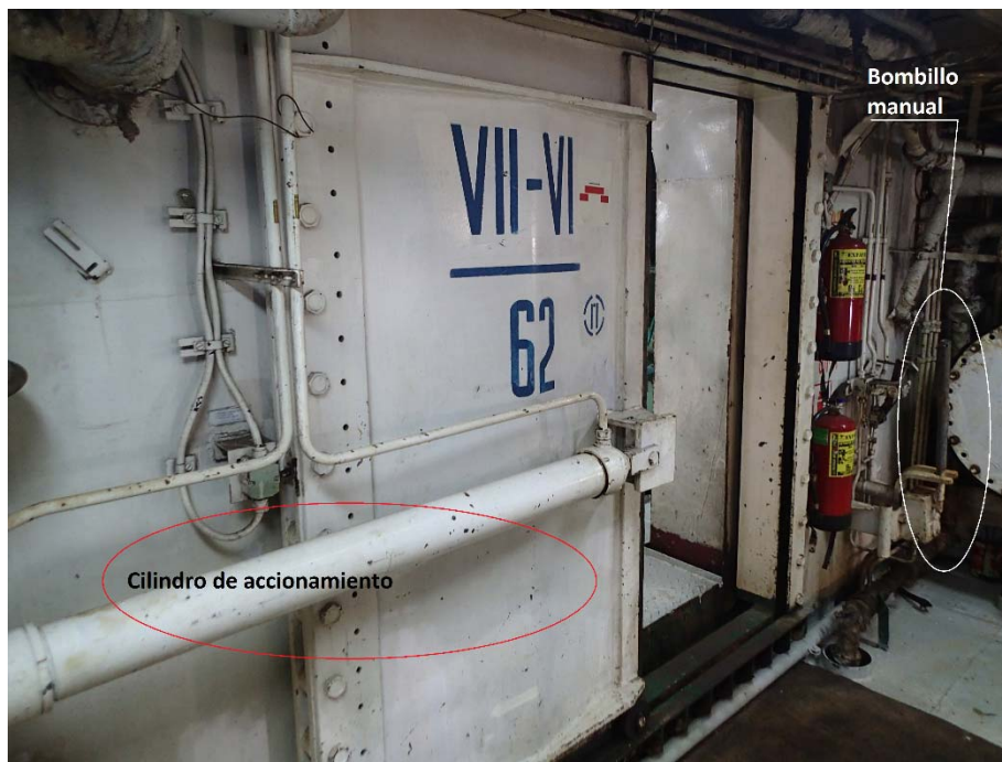
Figura 26. Puerta estanca de accionamiento hidráulico (proa)
