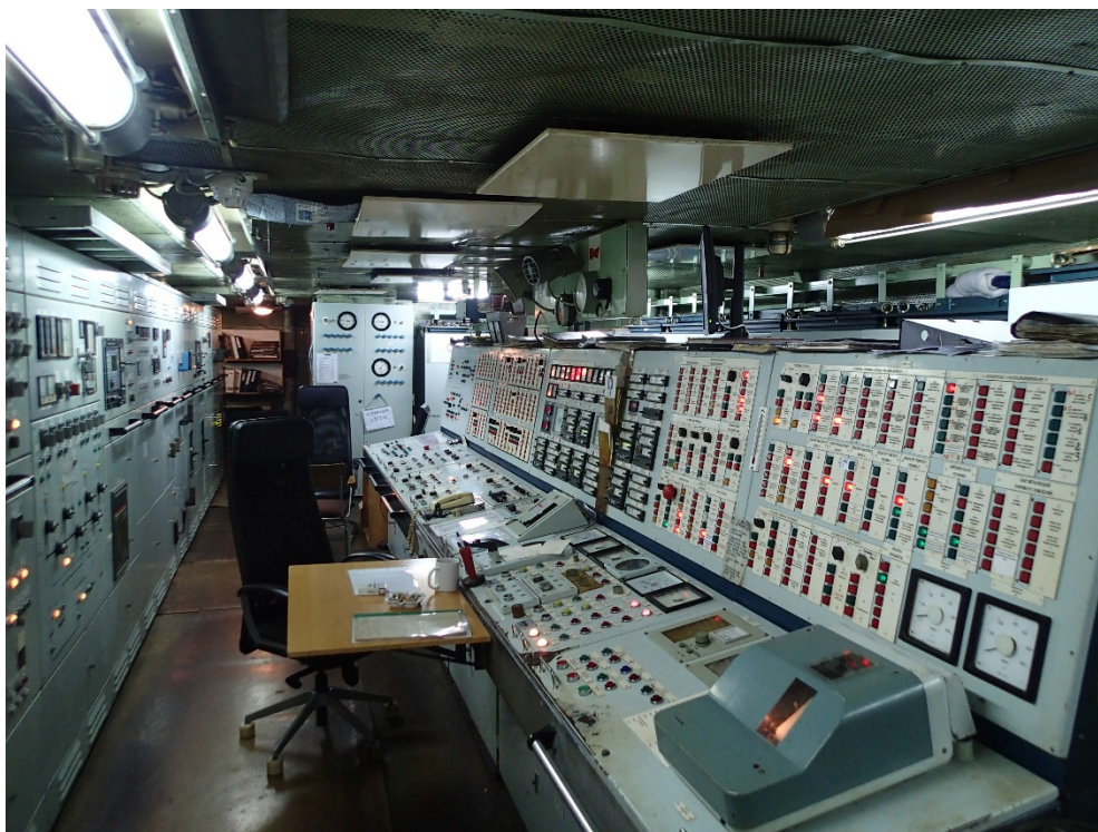
Figura 22. Sala de control de máquinas y Cuadro eléctrico principal
