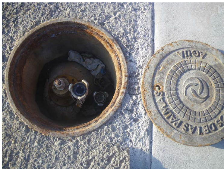
Figura 28. Insuficiente caudal de la red de agua del muelle
