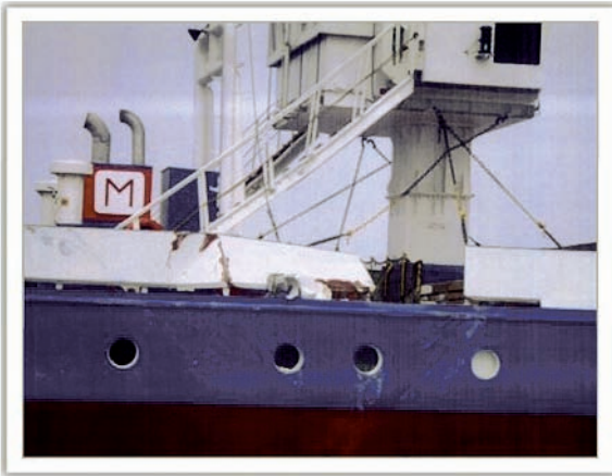
Figura 8. Zona del costado de estribor del mercante que recibió el impacto
