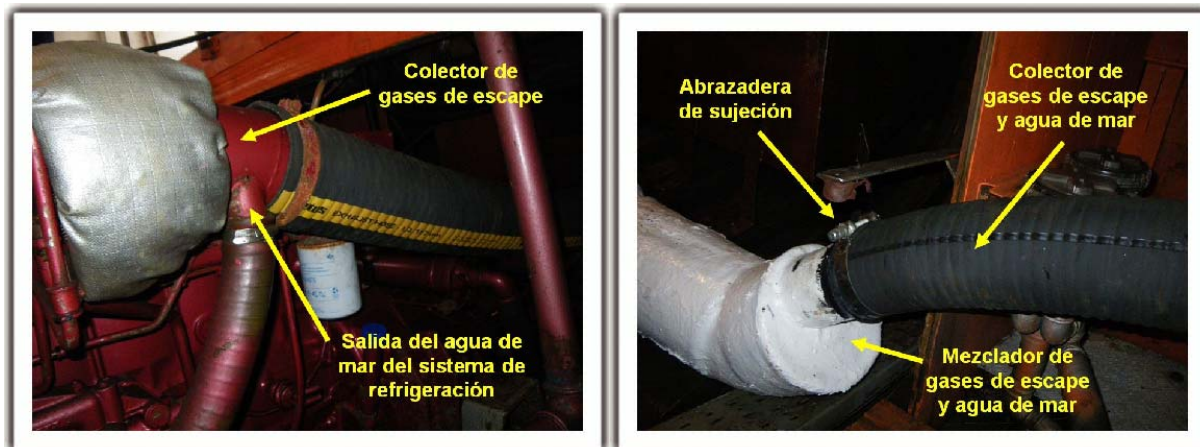
Figura 3. Colector (tras su sustitución) en el que se produjo la rotura
