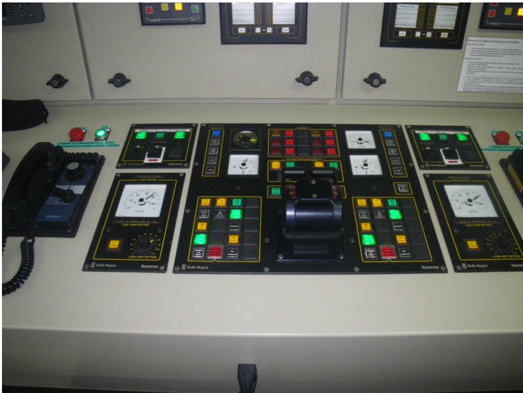
Figura 12. Sables del sistema KAMEWA en la sala de máquinas
