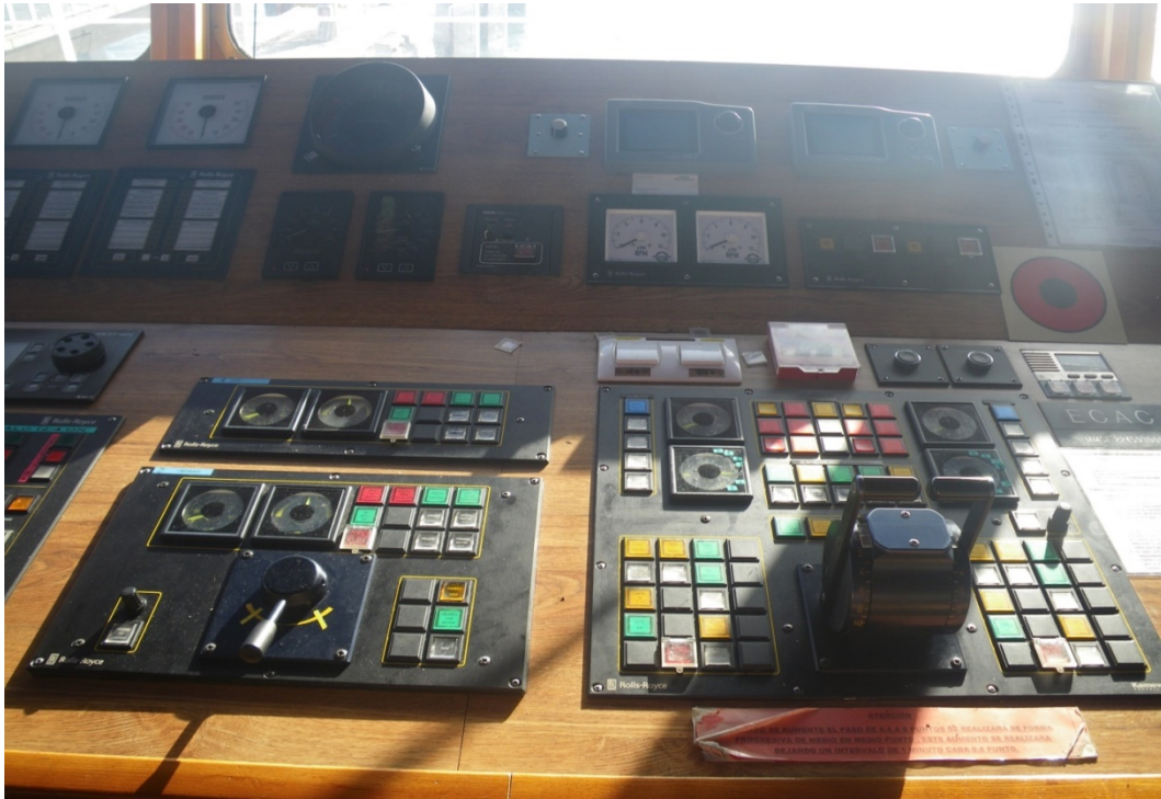
Figura 11. Control del sistema KAMEWA en el puente, zona central.
