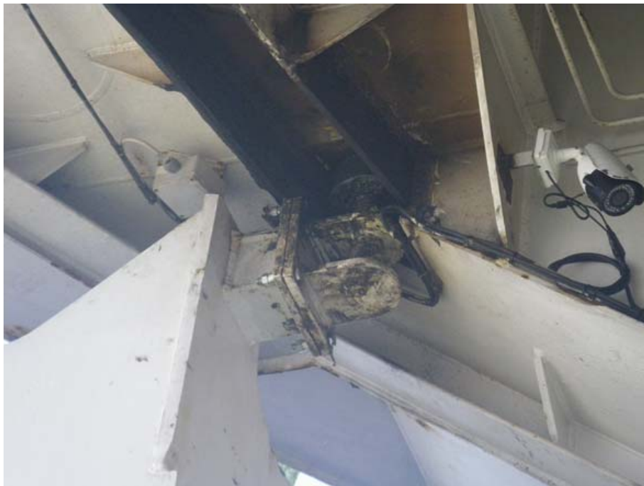
Figura 6. Zona del accidente. Detalle con tornillos reemplazados.
