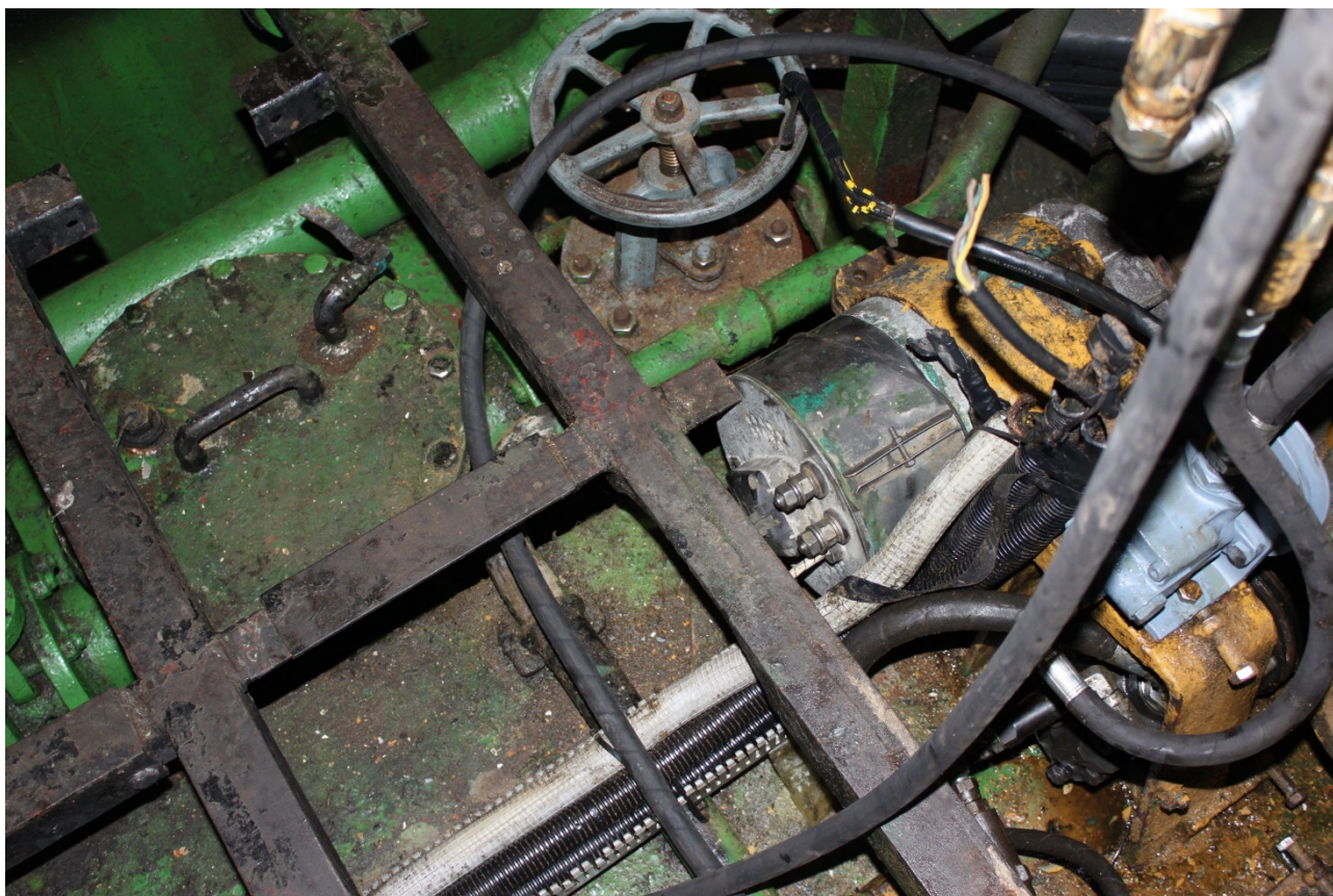
Figura 4. Detalle del lugar del incendio, sin las chapas del plan.
