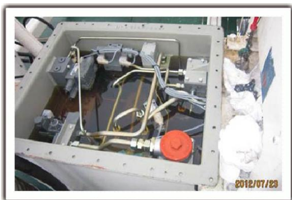
Figura 6. Central hidráulica del pescante
