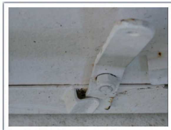
Figura 13. Trinca de una puerta de desagüe
