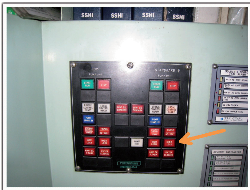
Figura 15. Detalle de la posición del indicador de bloqueo hidráulico en el panel de alarmas del sistema de gobierno
