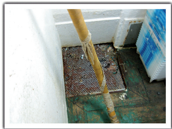
Figura 18. Rejilla del pocete de achique de la bomba de estribor
