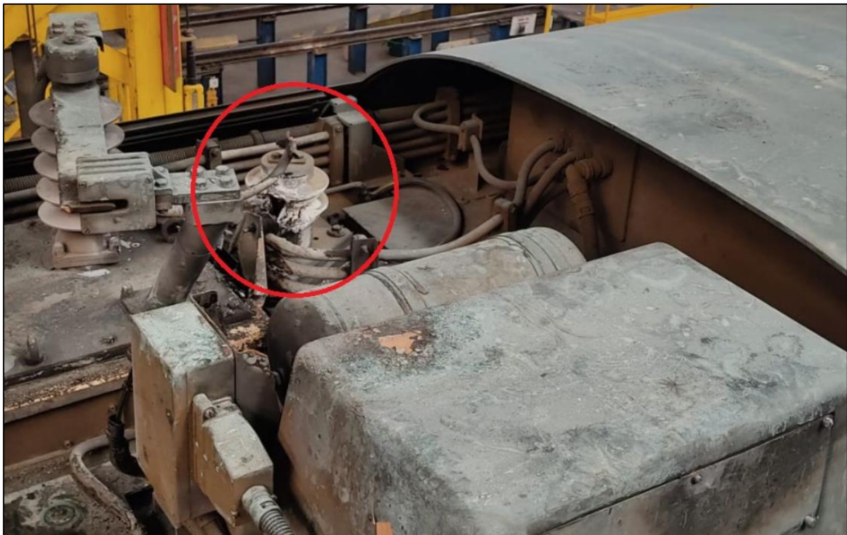
Figura 11 Daños en el pararrayos 3 kV MCP
